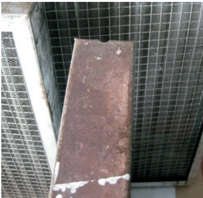
Figura 3. Filtros de cocina pintados (modelo malla) y retirados a un nuevo cliente. Foto: Sercaval.
