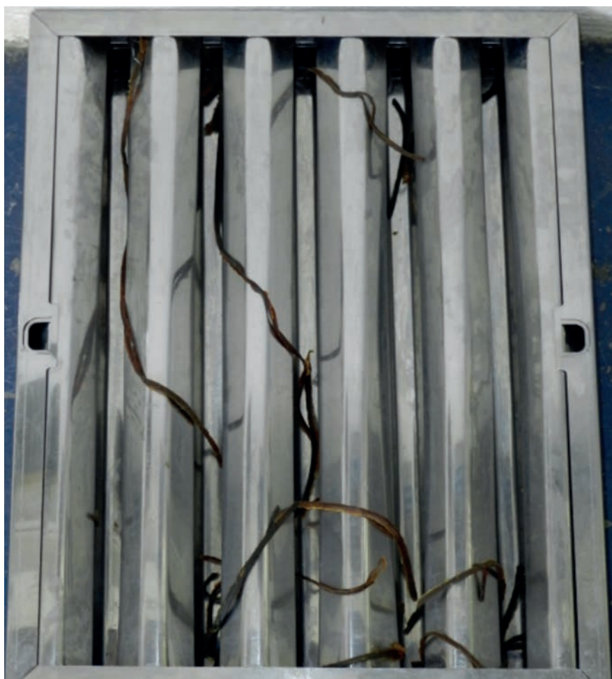
Figura 9. Filtro de modelo lama que era limpiado por personal de un hotel. Véase el detalle de las tiras de grasa que estaban en su interior y que demuestra que no basta solo con limpiar la cara vista del filtro. Foto: Sercaval.
