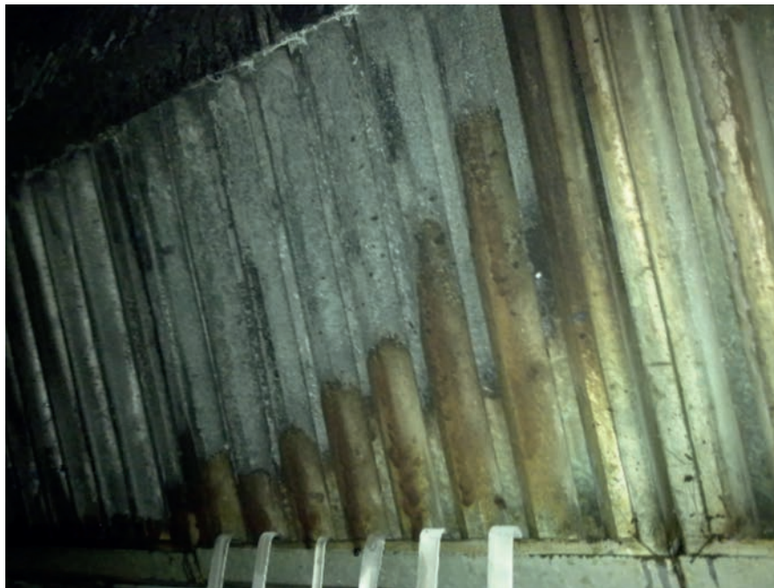
Figura 1. Filtros pintados (modelo de lamas) en una cocina de un establecimiento hostelero de Valencia en la que se ha producido un incendio.
