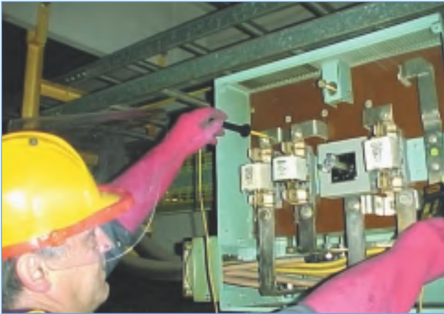
Figura 11. Comprobación de ausencia de tensión en la entrada.
