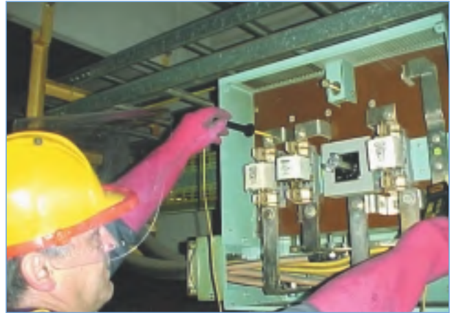
Figura 12. Comprobación de ausencia de tensión en la salida.
