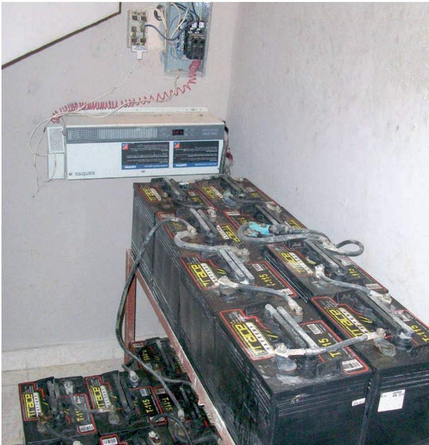
Instalación típica de inversor y batería en Puerto Príncipe (Haití) para protegerse de los apagones. Foto: S.L.P.
