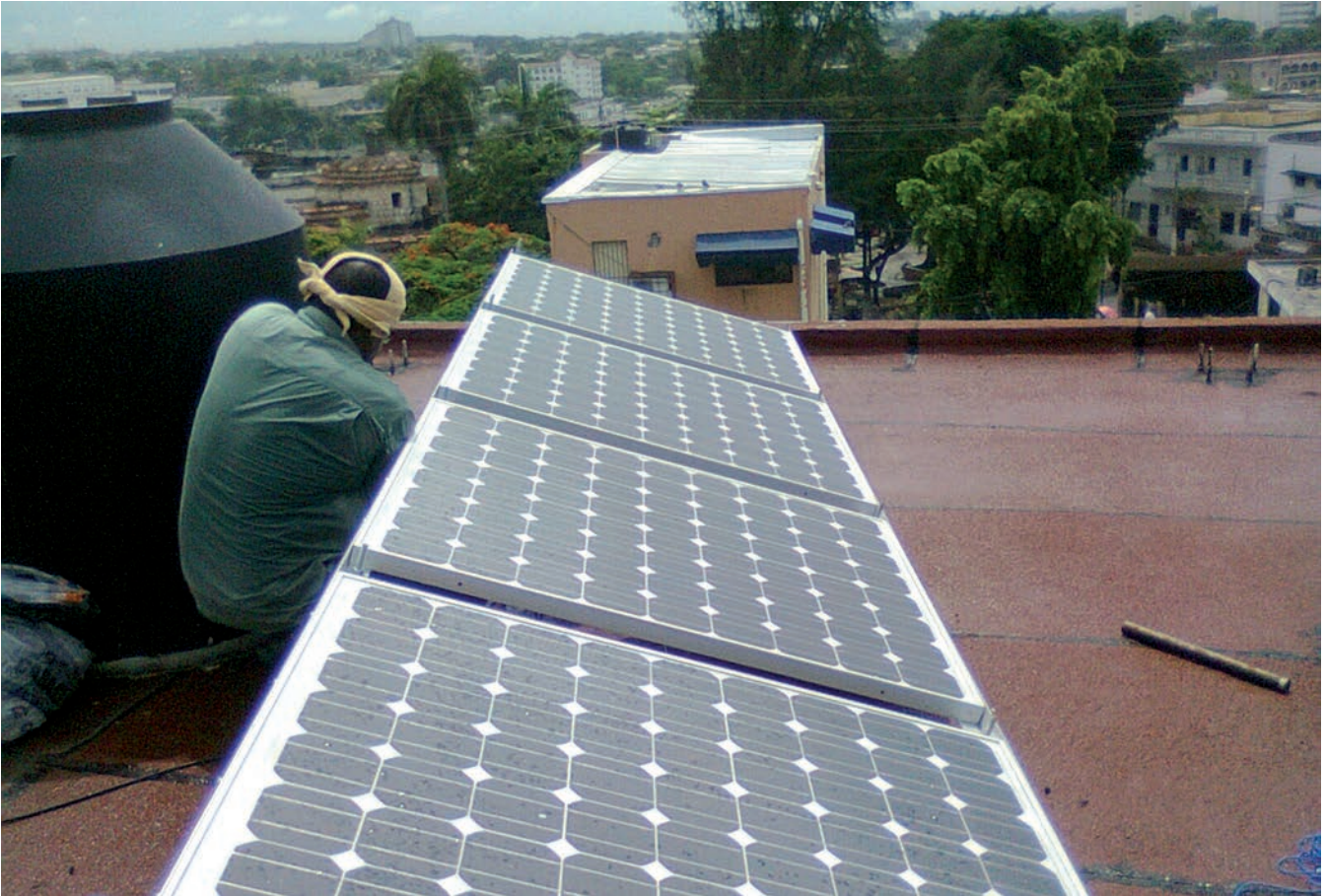
Instalación fotovoltaica aislada ubicada en Santo Domingo (República Dominicana) como medio para protegerse ante los apagones. Foto: S.L.P.
