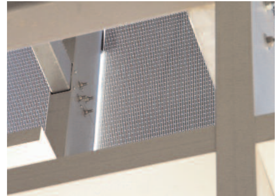
Figura 2. Detalle del interior de un elemento de fachada construido con módulos semitransparentes de silicio amorfo. Centro comercial La Albufera, Madrid.
