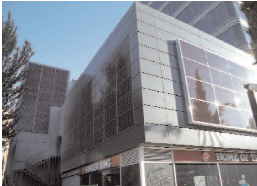
Figura 9. Módulos de silicio cristalino y amorfo integrados en la fachada ventilada del centro comercial La Albufera, Madrid.
