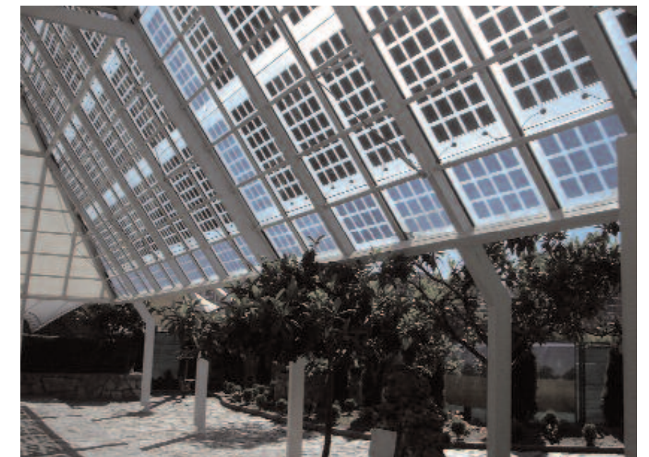
Figura 8. Integración de módulos fotovoltaicos con estructura de doble vidrio en uno de los accesos al centro comercial La Vaguada, Madrid.
