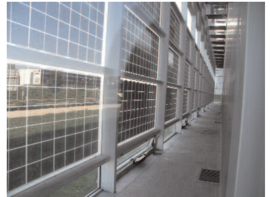
Figura 1. Fachada fotovoltaica con módulos con estructura de doble vidrio. Las células ejercen un cierto sombreado de la cara sur del edificio y filtran parte de luz al interior. Sede social de Acciona Solar en Sarriguren, Navarra.
