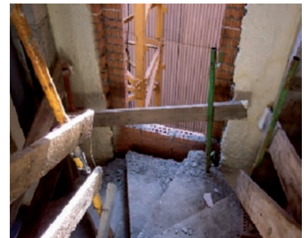
Figura 3. Fijación ni firme, ni segura.
