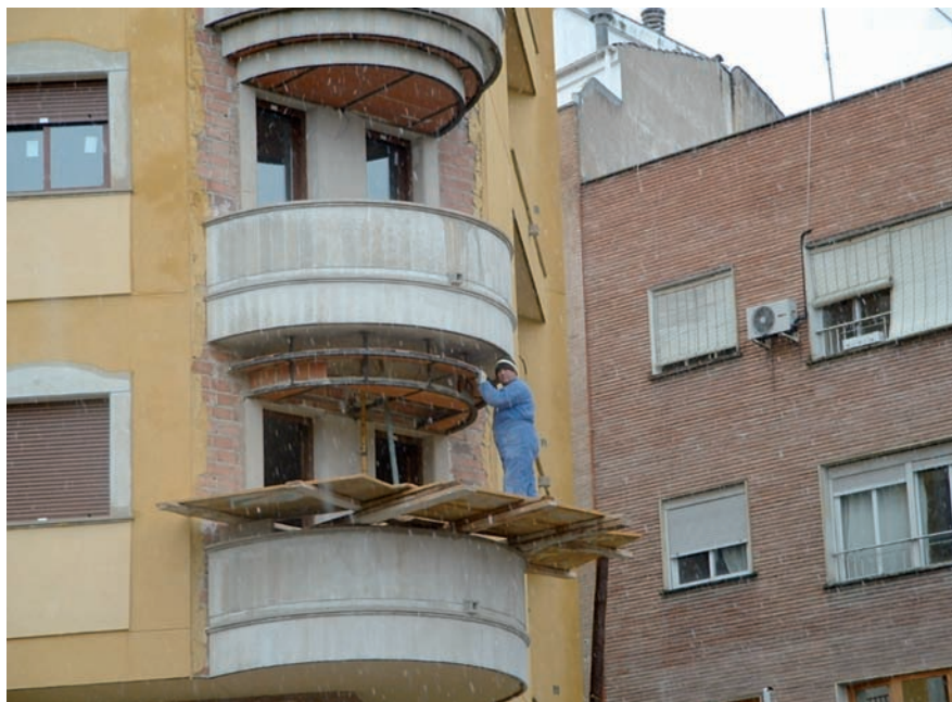
Figura 1. Operario en situación de riesgo de caída en altura.
