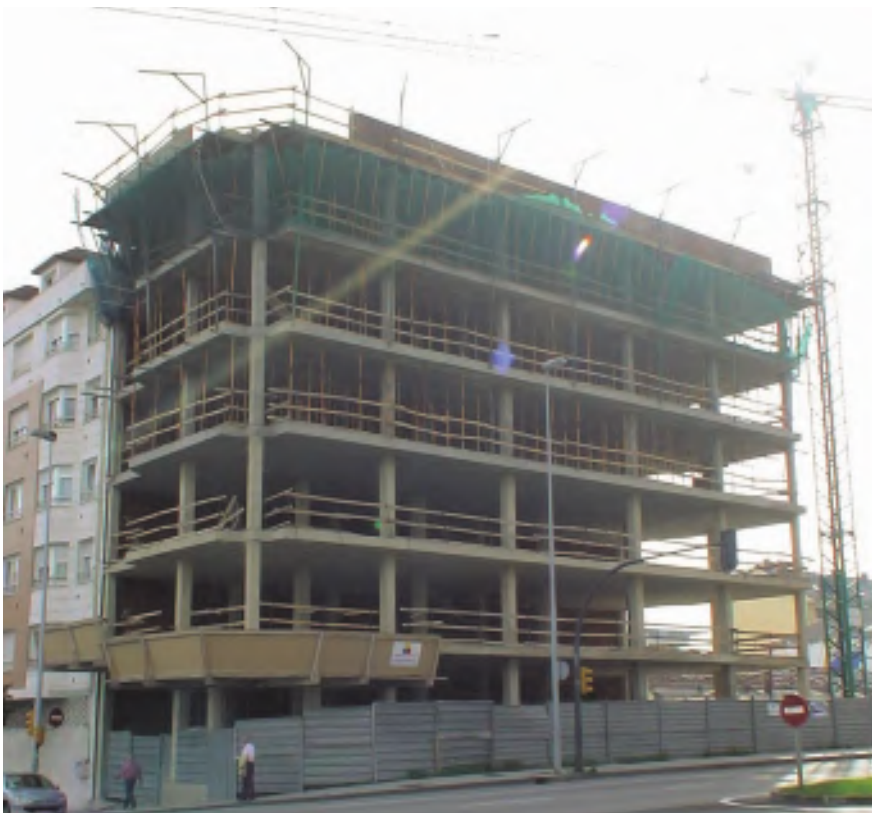
Figura 5. Edificio en construcción, donde fácilmente se aprecia la falta de continuidad del pilar de la esquina izquierda en la planta baja.
