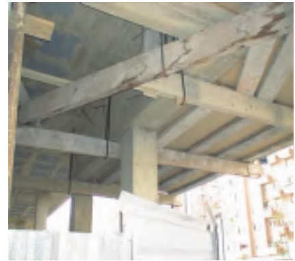
Figura 6. Los esfuerzos transmitidos por el pilar citado son soportados por una pareja de vigas de gran canto (colocadas horizontalmente y formando un ángulo recto entre sí), que, vinculadas a los pilares contiguos, cubren la esquina.
