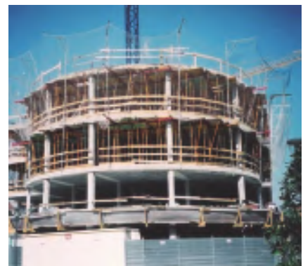
Figura 7. La colocación girada de las columnas agrava la vulnerabilidad sísmica del edificio.
