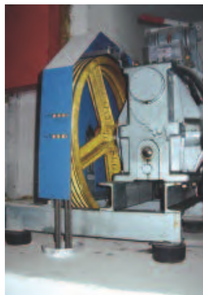
Figura 1. Máquina tractora eléctrica con reductor sinfín-corona, utilizada en tiro directo, montada sobre tacos elásticos de caucho para aislarla de la losa.
