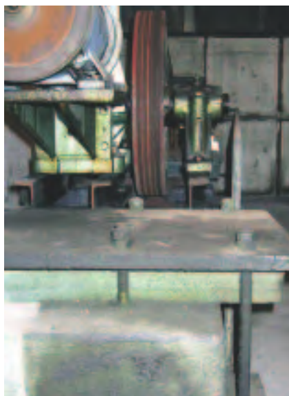
Figura 7. Máquina de un ascensor montada sobre una bancada metálica cimentada y aislada de la losa del cuarto de máquinas mediante unas planchas de material aislante.
