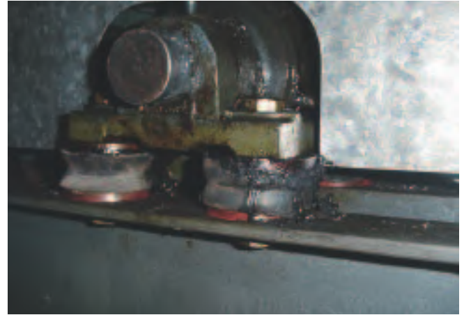
Figura 3. Silleta de una polea de desvío aislada mediante tacos aislantes de caucho. Se puede observar que son agredidos por la grasa utilizada para el engrase del casquillo eje polea.
