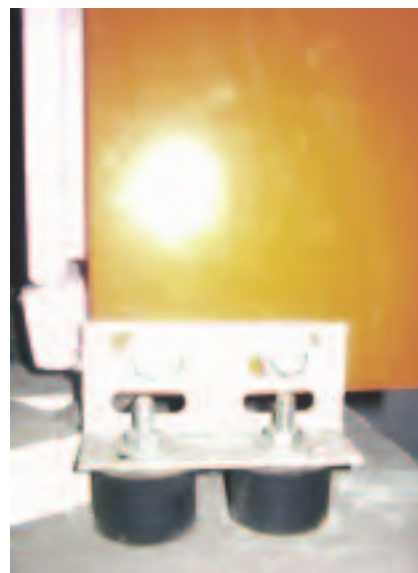
Figura 8. Cuadro de maniobra montado sobre la losa del cuarto de máquinas a través de unos tacos aislantes de caucho.
