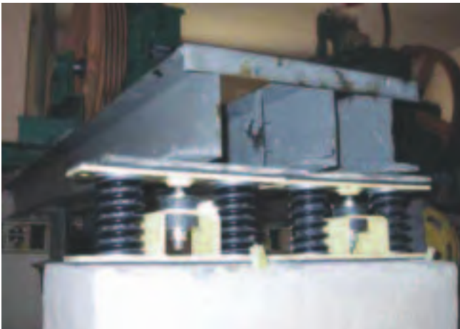
Figura 4. Conjunto de bancada metálica con una máquina tractora y una polea de desvío. Todo ello está aislado de la losa del cuarto de máquinas de un ascensor por medio de aisladores metálicos de muelle.
