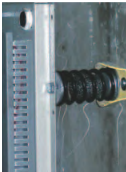
Figura 6. Soporte del cuadro de maniobra de un ascensor aislado de la pared del cuarto de máquinas mediante muelles metálicos que llevan en su interior una malla de hilo de acero inoxidable.
