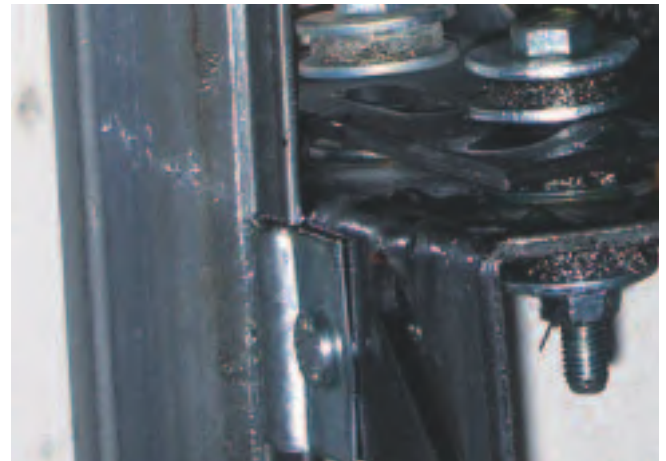
Figura 5. Soportes de guías de contrapeso de un ascensor aisladas mediante cojines metálicos en hilo de acero inoxidable, de las paredes del hueco.
