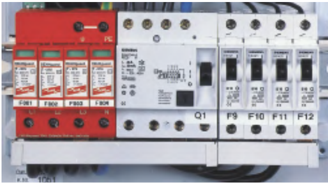
Figura 3. Descargador de sobretensiones.
