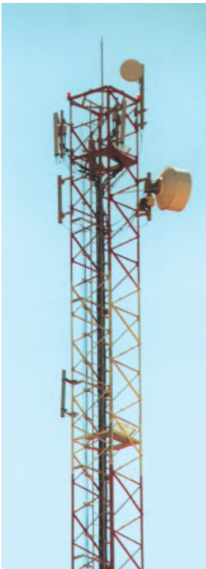
Figura 2. Torreta para enlace de microondas.
