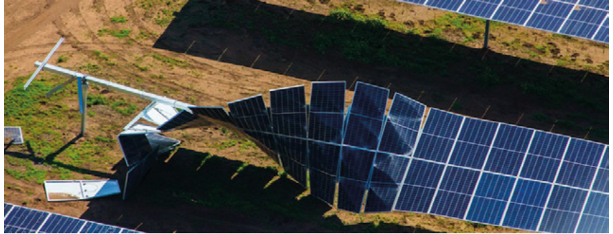
Efectos del colapso estructural de los seguidores. Foto: pv-magazine-usa.com.
