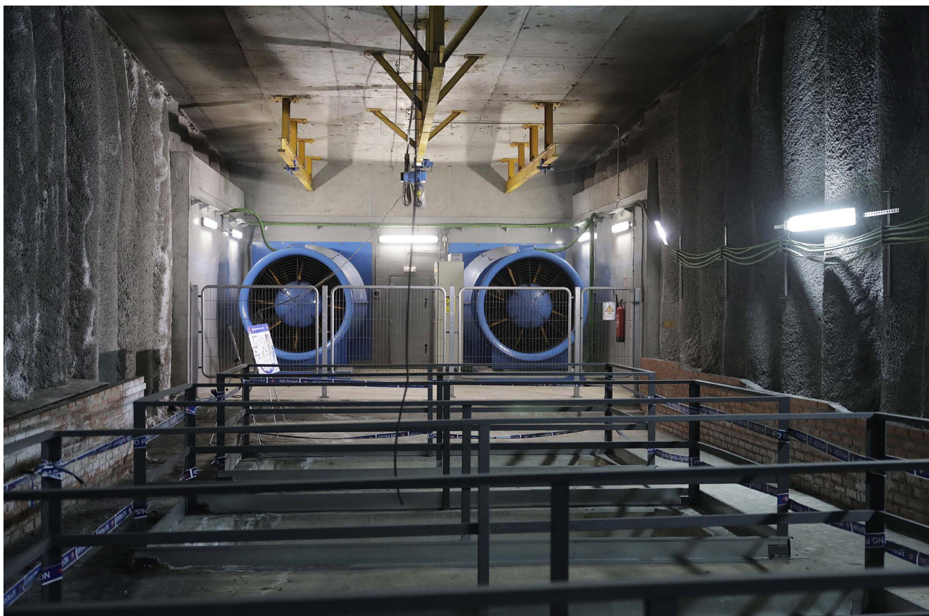
Las instalaciones de ventilación pueden llegar a suponer el 40% del consumo energético del metro. Gracias al sistema de gestión inteligente, el ahorro energético es del 25% y se evita la emisión de 93 toneladas de CO 2 al año.
