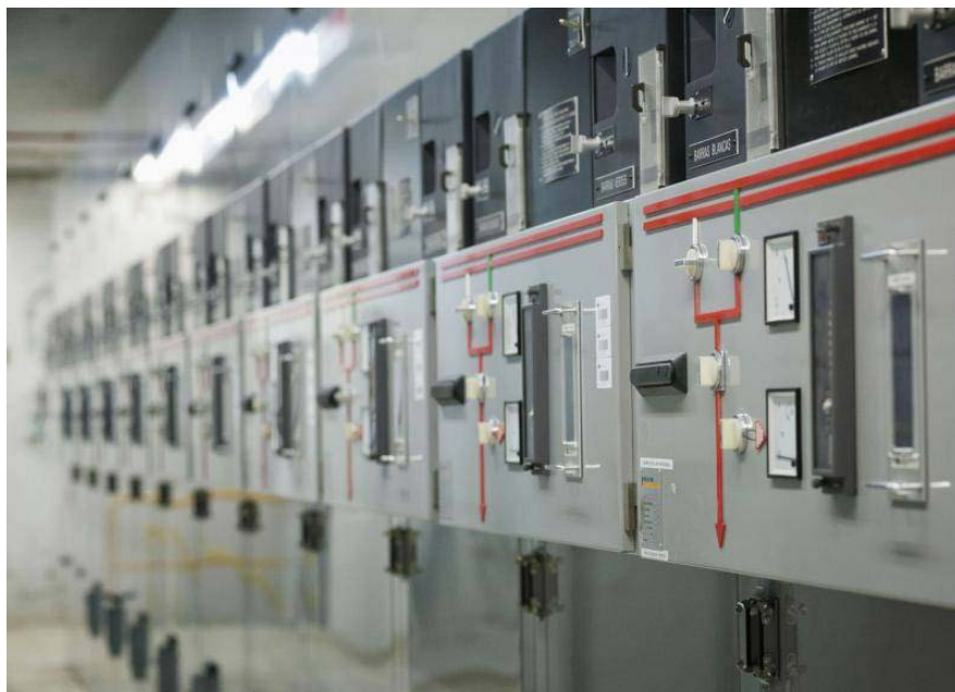
En 2015 se implementó un sistema de recuperación de energía eléctrica, que permite un ahorro equivalente al consumo de, aproximadamente, 1.000 personas al año en la Comunidad de Madrid.
