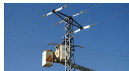
Un operario corrige un tendido eléctrico para evitar el grave impacto que estas instalaciones causan en las aves. Foto: AQUILA a-LIFE.
