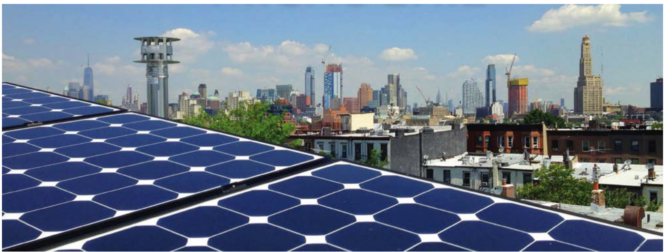
Placas solares en los tejados de los edificios de Brooklyn Microgrid. Fuente: Siemens.
