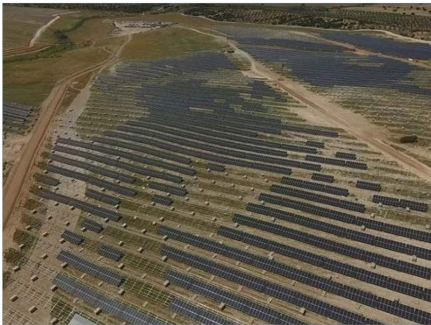
Proyecto fotovoltaico Núñez de Balboa, de 500 MW, que Iberdrola está construyendo en Extremadura. Fuente: Iberdrola.
