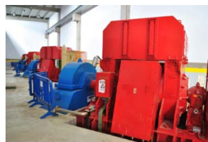
Turbinas. Interior de la Central de Bombeo. Foto: IDAE.
