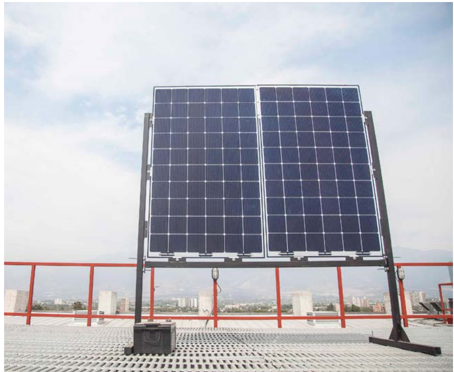
Paneles solares bifaciales desarrollados en Chile. Foto: Universidad Católica de Chile.
