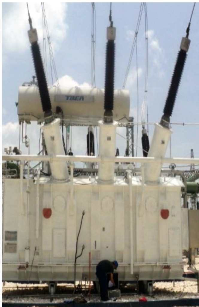
Figura 8. Autotransformador 125 MVA 220/110/11 kV.
