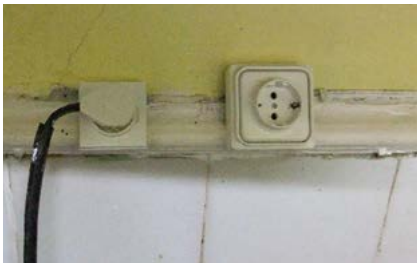
Figura 5. Derivaciones de enchufes sin toma de tierra, con cableado de suministro inadecuado.
