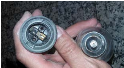
Figura 6. Contacto eléctrico de un portalámparas deteriorado.
