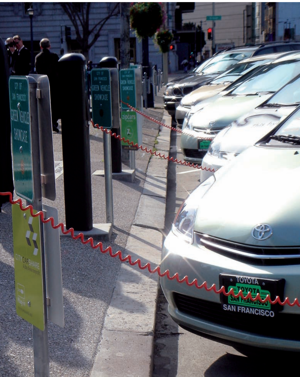
Punto de recarga de baterías de automóviles híbridos enchufables en San Francisco (Estados Unidos).
